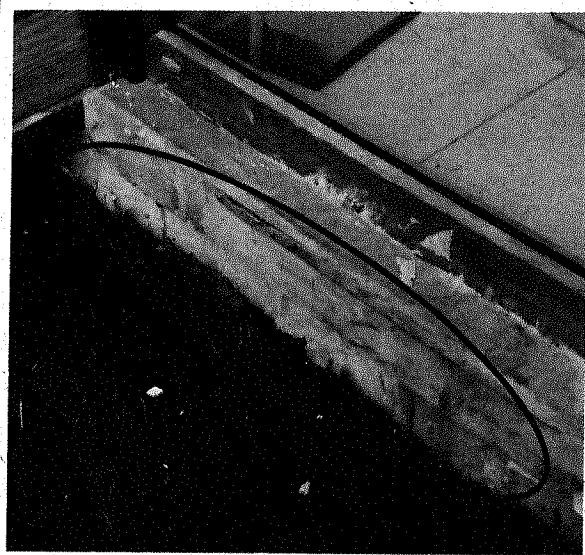
Fotografía N° 3: Sobrecimiento a la vista, sin notarse retorno de aislapol desde fundaciones.
